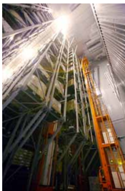
立体自動倉庫
